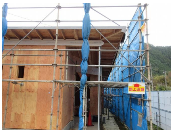
1F 屋根 野地板（写真はポーチ部分）： JAS 構造用合板 厚 12mm
