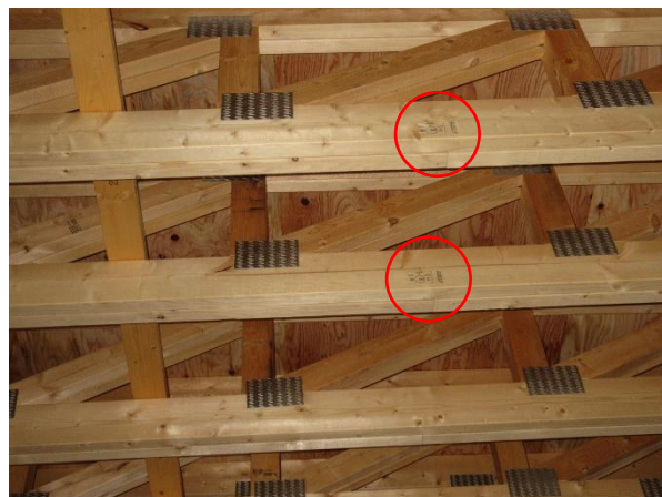
1F 冷蔵庫 X6~9×Y11~8 通 トラス： JAS 枠組壁工法用製材 JAS マーク
