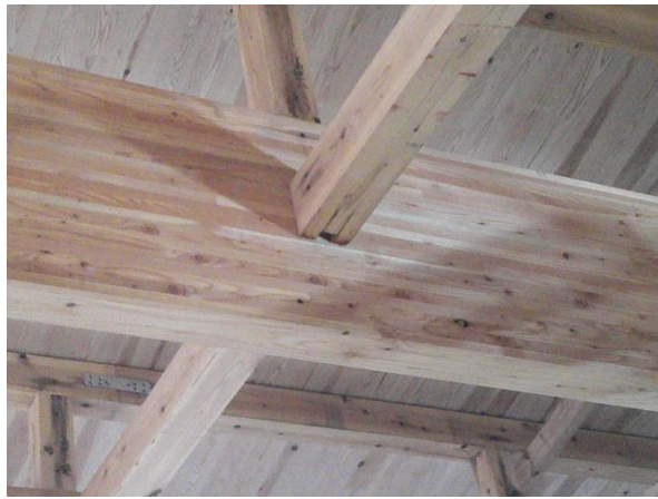
1階機能訓練室 X3 通り 梁 B7 : 120×600、B12 : 120×150 両方共 JAS 構造用集成材、束 : 120×120 杉一等
