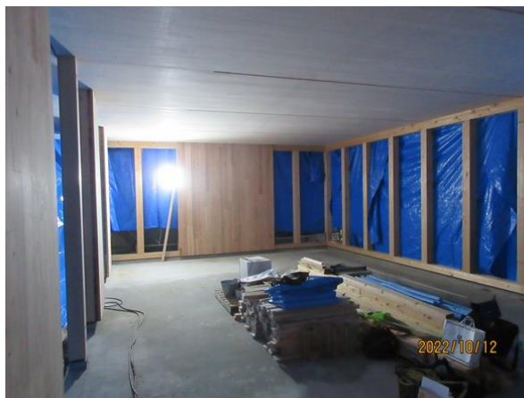
1階 Y1 通 柱 ヒノキ 機械等級製材 及び内観 (2階床天井面 CLT パネル)
