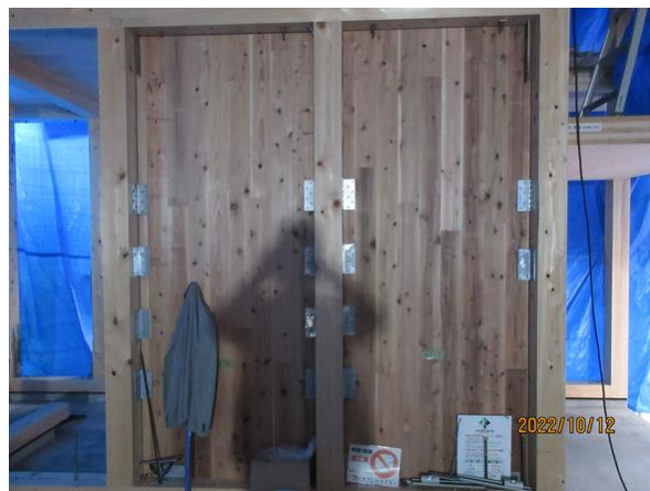
1階 X2-Y3~6 柱 機械等級製材及びCLT パネル
