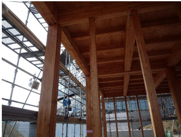
1階 い通り南西方向柱・梁 JAS 構造用集成材
